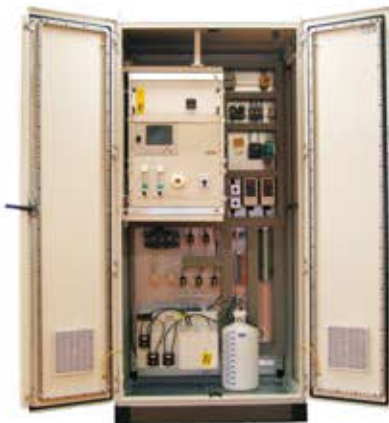
Sistem de monitorizare continuă a emisiilor poluante- CEMS
